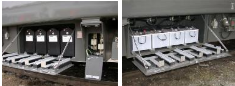
Abbildung Batteriekästen mit Batteriehaupsicherungen
